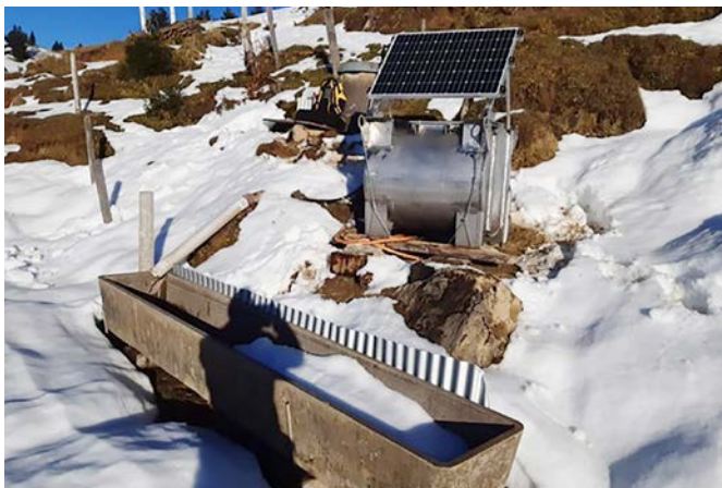
Wasserspeicher mit PV-Pumpe im Bereich Aussergheist
